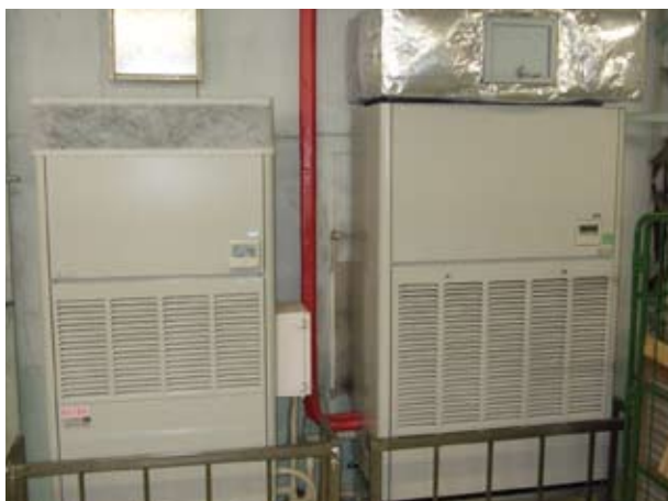
更新した空調設備(平塚工場)
