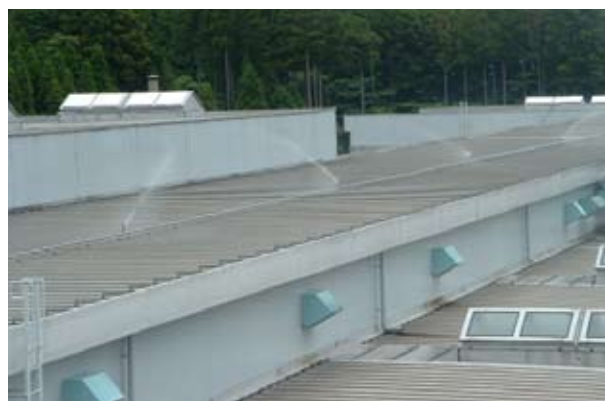
屋根の散水装置(富士裾野工場)
