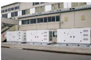
設置した自家発電機
